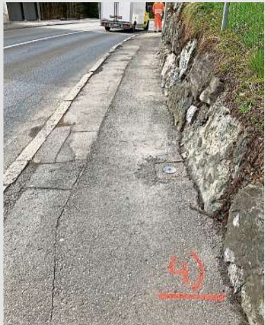
Der Belag des Trottoirs der Zugerstrasse muss repariert werden. Foto: zvg
