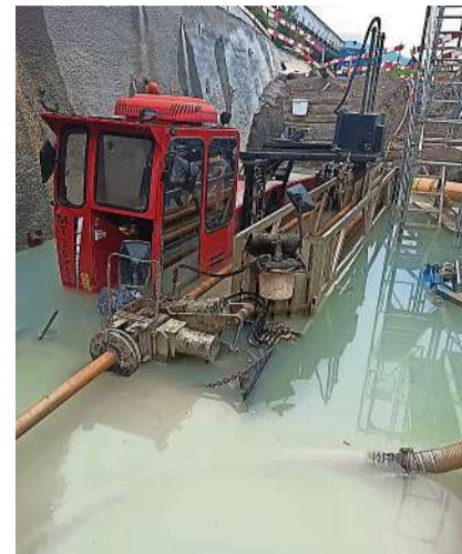
Das in der Baugrube gestaute Wasser hat zu einem Defekt an einer Baumaschine geführt.
