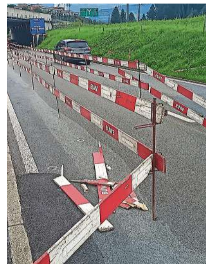
Ein unbekanntes Fahrzeug ist in eine Baustellenabschrankung geprallt. Fotos: zvg
