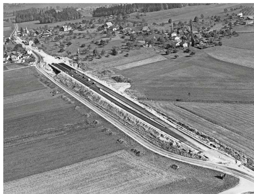
165 Kilometer misst die Autobahn A4, die in Uri beginnt und in Thayngen kurz vor der deutschen Grenze aufhört. Aus dem Herbst 1969 stammt dieses Foto, das die Bauarbeiten für die A4 bei Rotkreuz zeigt.
