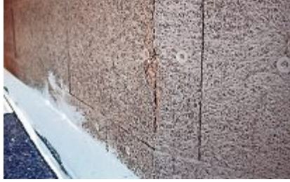
Nicht zu übersehen; diese Ecke des Parkhauses Postplatz wurde schon von einigen Lenkern touchiert. Dementsprechend heisst es auch bei neu gebauten und breiter wirkenden Garageneinfahrten: Aufgepasst, sonst wirts' teuer! Kristina Gysi
